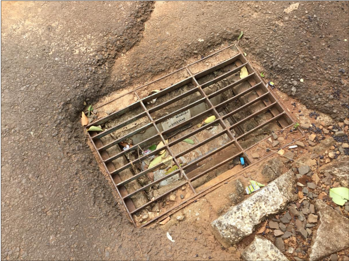
Figura 37 – Dispositivo de microdrenagem obstruído encontrados no dia da visita de campo.
