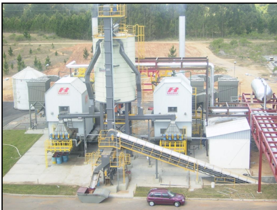
Figura 10: Módulo Gerador de Energia Elétrica Fonte: Alkem
